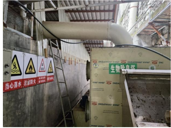
废气处理设施
