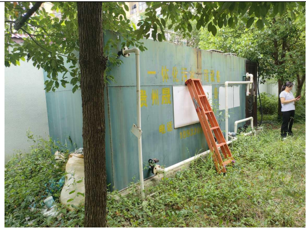
污水处理设施
