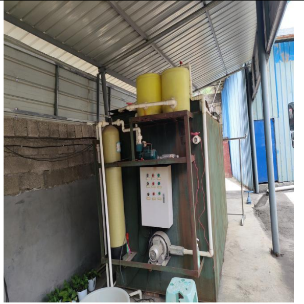
生活污水处理设施
