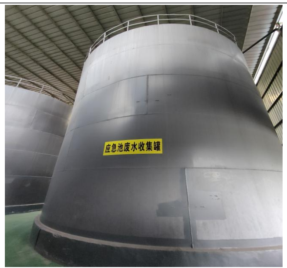
应急废水收集罐
