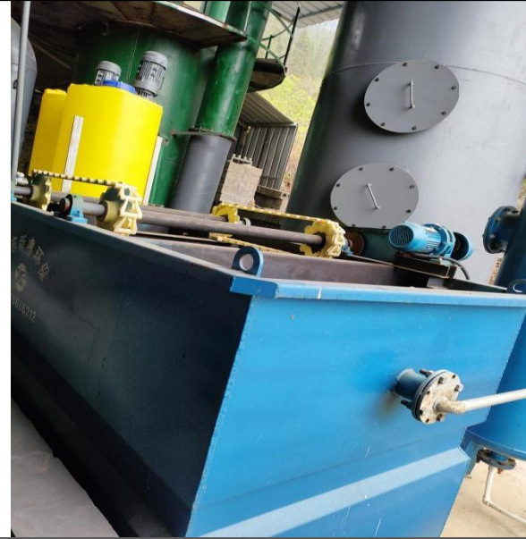
生产废水处理设施
